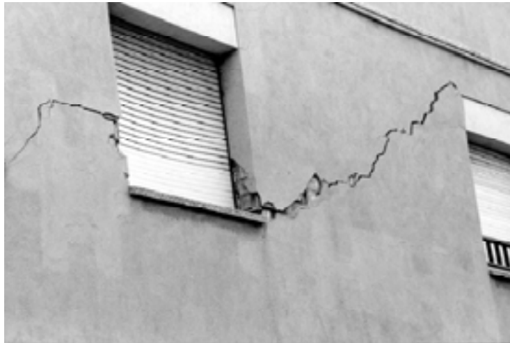
Foto 1. Detalle de unas grietas en edificios del Barri de l'Estació (Sallent, Catalunya)
